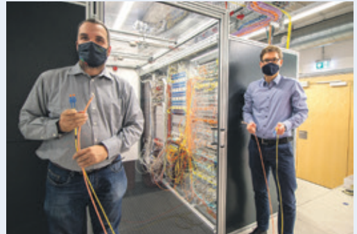
Diese bunten Kabel haben es in sich: Die Projektbetreuer Harald Rabenstein von der Hochschule Ansbach und Stefan Klement von den Stadtwerken zeigen, dass die Glasfaser bis in den Serverraum verlegt ist.
