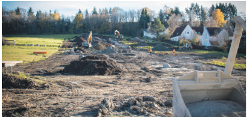
Der Traum vom Eigenheim lässt sich jetzt im Neubaugebiet „Galgenmühle“ verwirklichen. Die awean hat bereits mit den Arbeiten begonnen.
