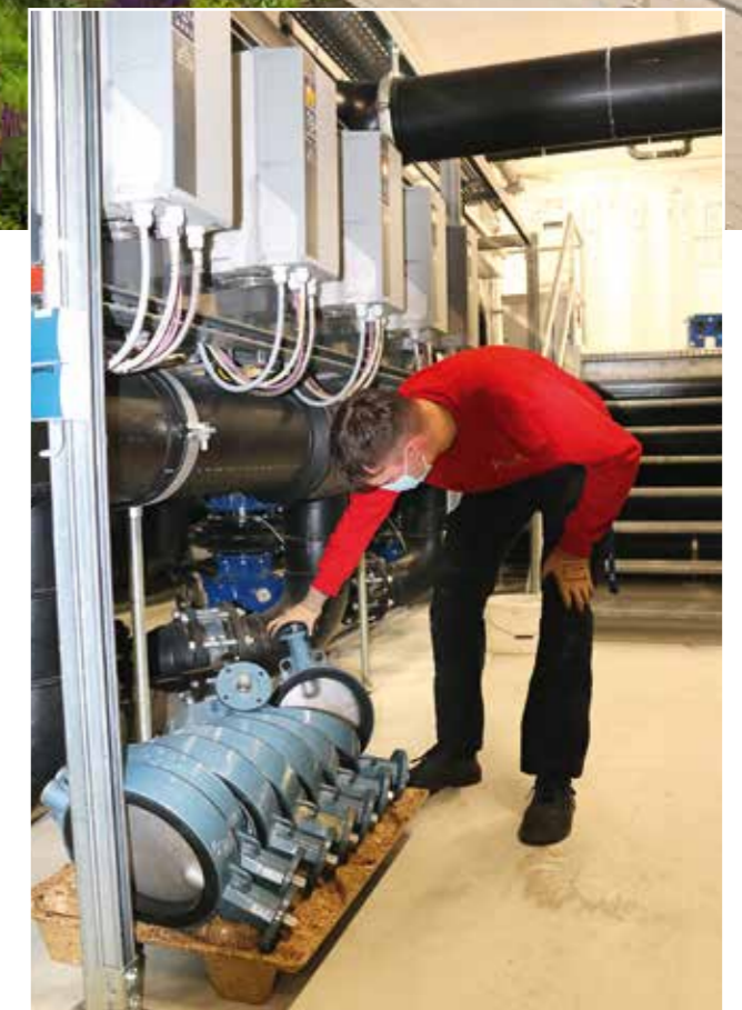
SIND ALLE EINBAUTEILE FUNKTIONSFÄHIG? JO-LUCA LUBER BEI DER KONTROLLE DER FILTERKLAPPEN.
