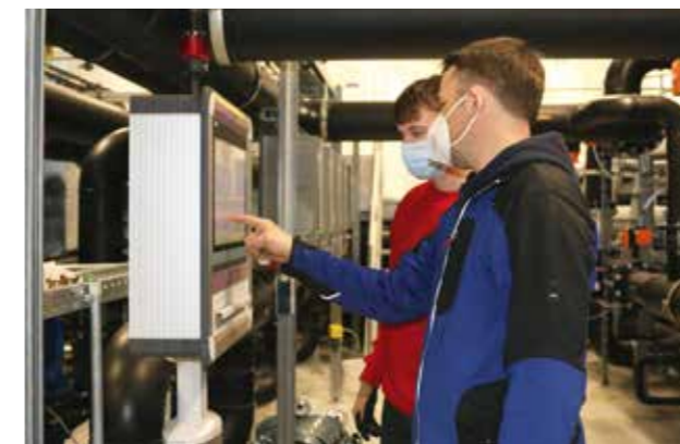
BEVOR ES LOSGEHT, WERDEN UNTER ANDEREM SCHALTZEITEN UND PARAMETER KONTROLLIERT.
