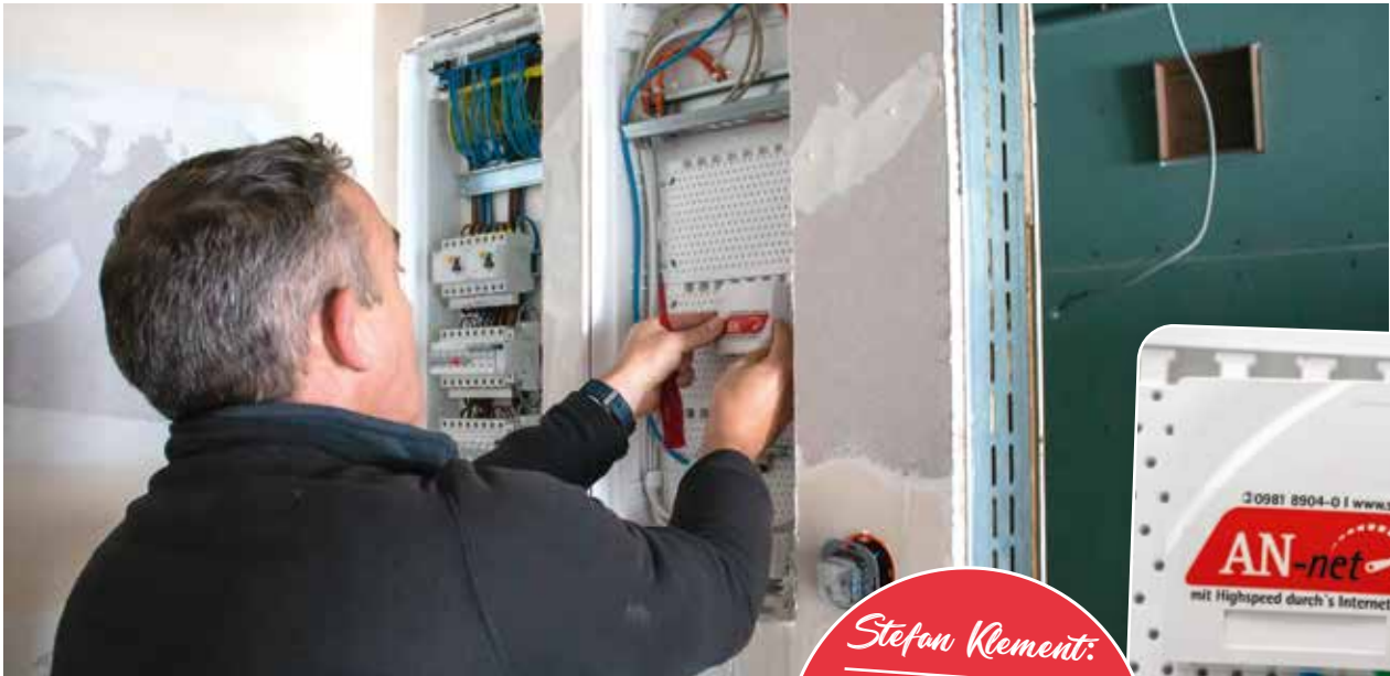
DIE SPLEISSBOX FÜRS AN-NET WIRD VON HERBERT BAYER INSTALLIERT. IN IHR WERDEN FASERN AUFGEFÄCHERT.
