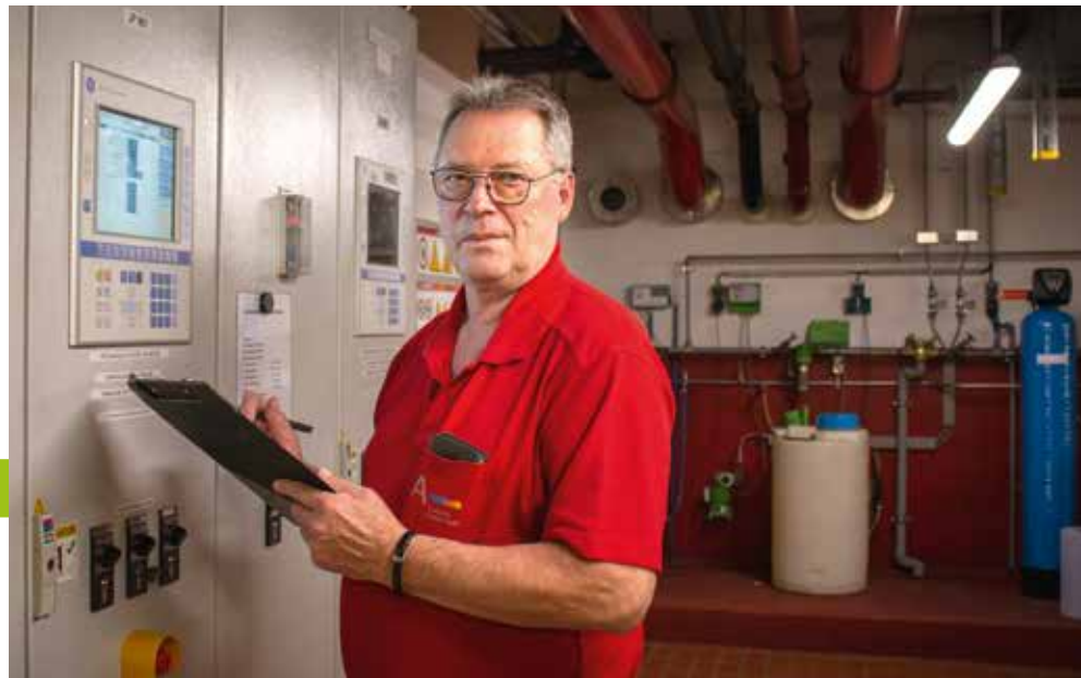
DIE KONTROLLE UND WARTUNG DER BHKW GEHÖREN ZU DEN HAUPTAUFGABEN DES FERNWÄRME-MONTEURS.
